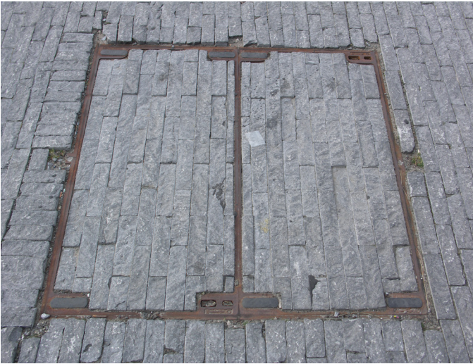
In het plangebied zijn WKO bronnen van het gebouw NPL aanwezig.
